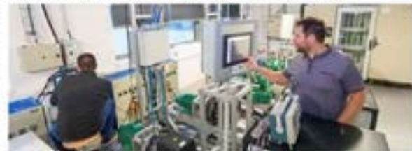
La salle des machines du micro-réseau électrique intelligent (smart micro grid), au sein du G2Elab, à Grenoble.
