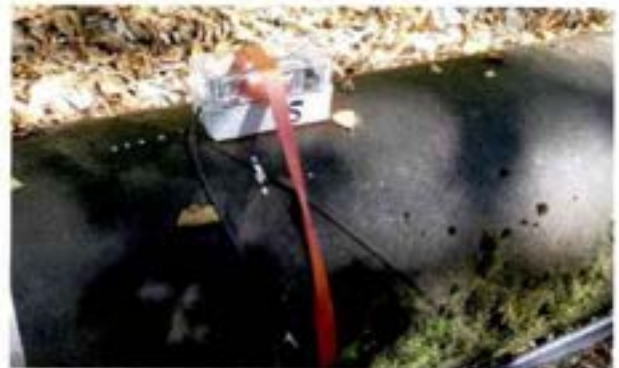
▲ Capteur acoustique installé sur la conduite forcée de la centrale des Moulins à Épierre (Savoie). Photo : Setec/Cetm
